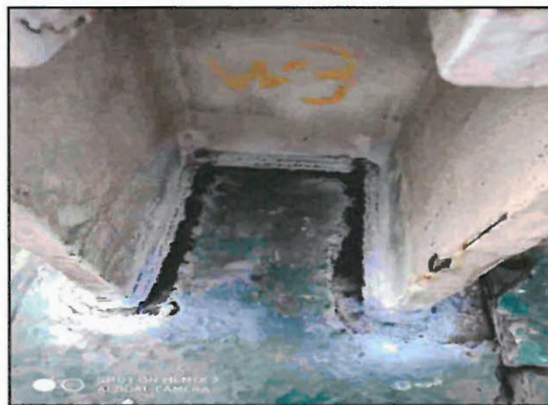
井架支座 4 号 W3(应力测试后)
