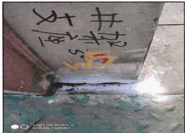
井架支座 3 号 W5(应力测试后)
