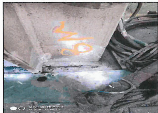
井架支座 2 号 W8 (应力测试后)
