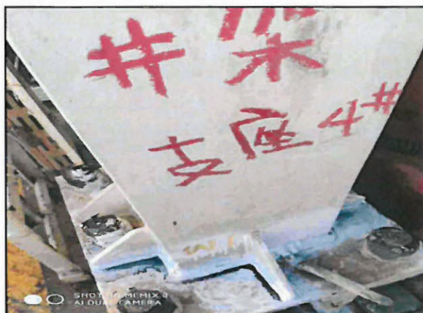
井架支座 4 号 W1(应力测试后)
