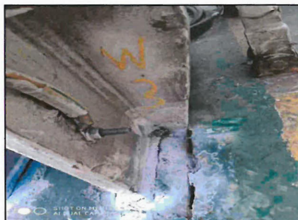
井架支座 1 号 W3 (应力测试后)
