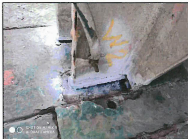
井架支座 4 号 W2(应力测试后)
