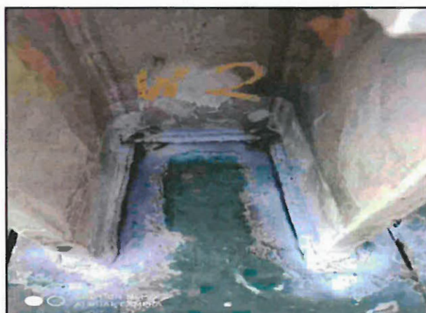
井架支座 1 号 W2 (应力测试后)
