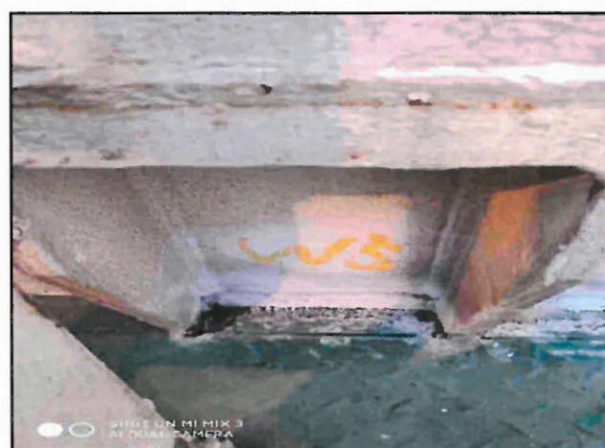
井架支座 4 号 W5(应力测试后)
