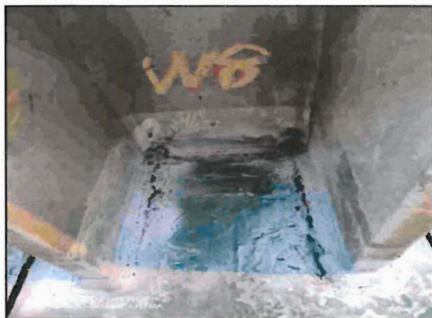
井架支座 3 号 W8(应力测试后)
