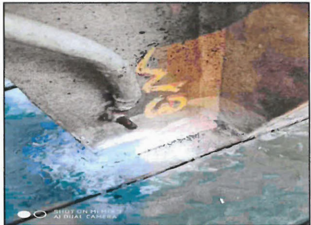
井架支座 3 号 W3(应力测试后)
