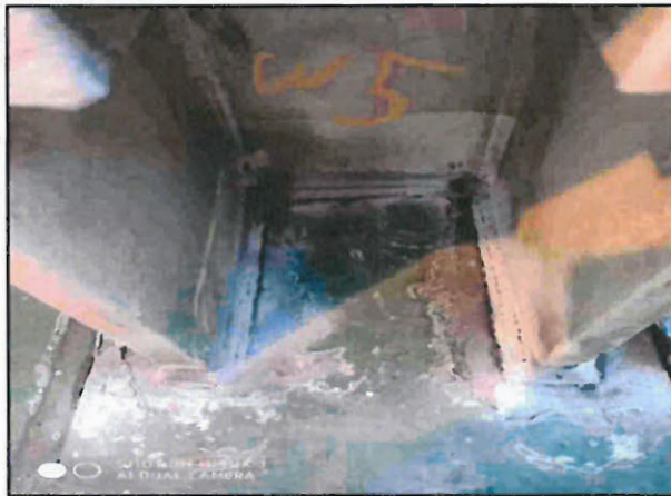
井架支座 2 号 W5 (应力测试后)
