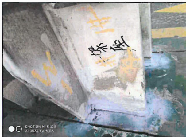
井架支座 1 号 W1 (应力测试后)
