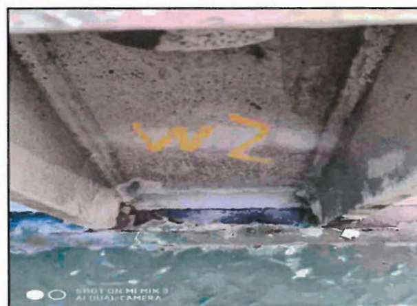
井架支座 2 号 W2 (应力测试后)
