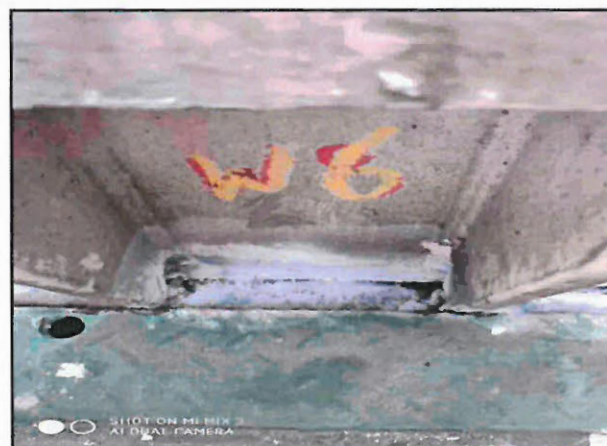
井架支座 3 号 W6(应力测试后)
