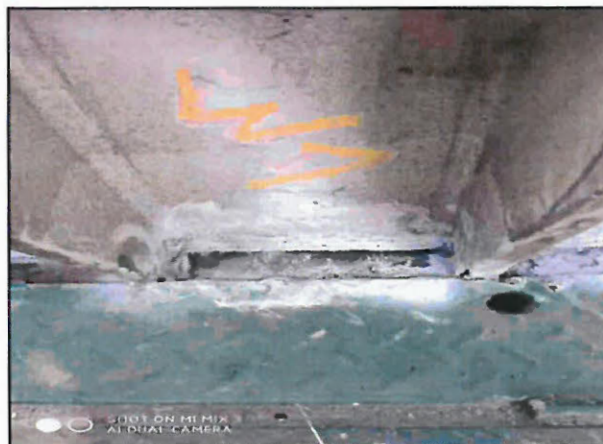
井架支座 2 号 W7 (应力测试后)
