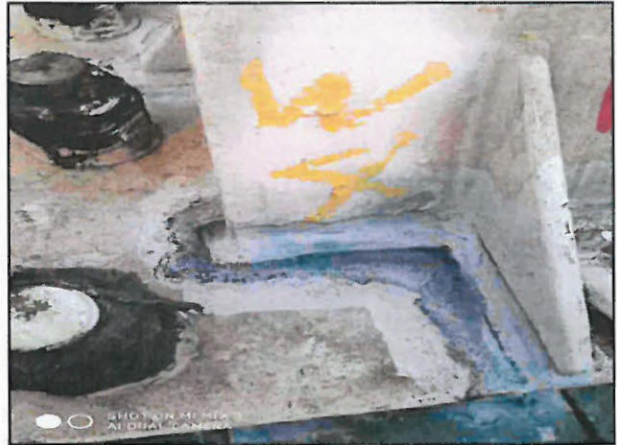
井架支座 2 号 W4 (应力测试后)
