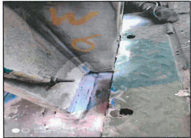
井架支座 2 号 W6 (应力测试后)
