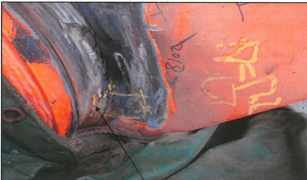
1#吊机 UT004 缺陷位置在焊缝中心位置, D=16~19mm L=46mm
